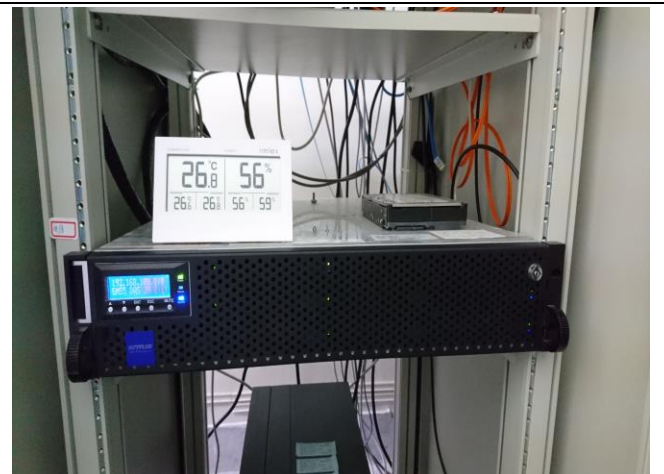
機房內設置的溫溼度計
