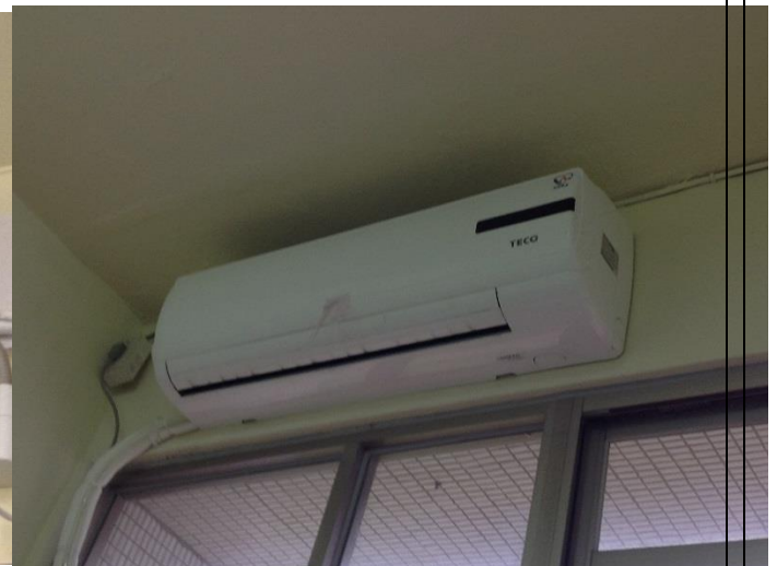
機房後端冷氣
