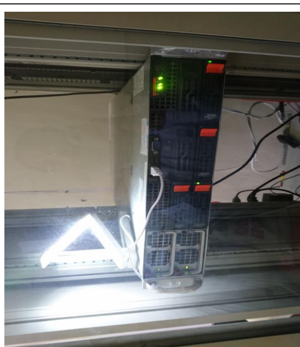
機房緊急照明電燈採用 USB 供電，電源間接來自於 UPS
