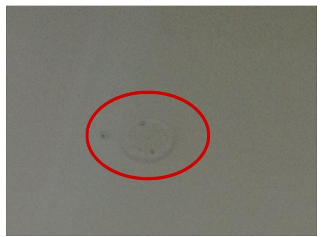
電腦教室天花板設置偵煙器
