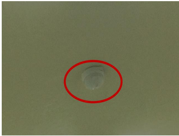
機房天花板設置偵熱器
