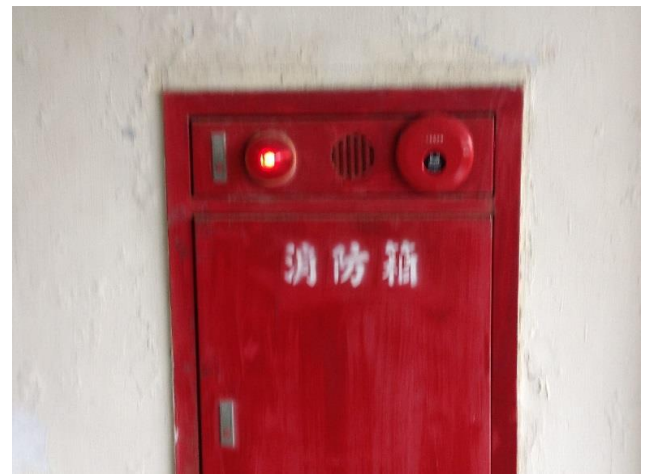
電腦教室外走廊之消防箱
