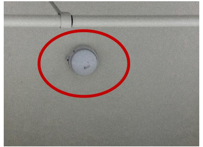
電腦教室天花板設置偵熱器
