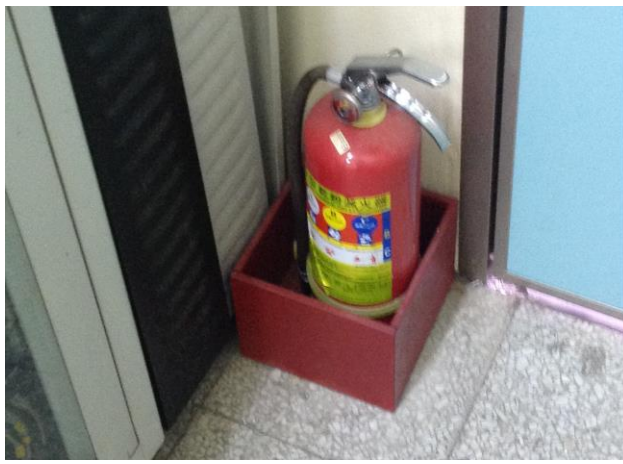
機房內消防滅火器
