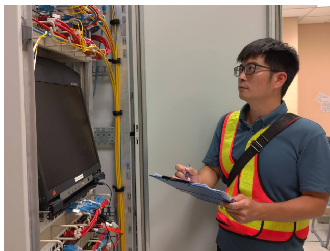
▲ 號誌系統機房設備檢視。
